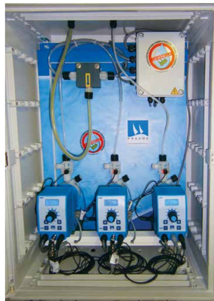
Оборудование дозирования диоксида хлора с активатором и продуктом, образующим защитную плёнку. Управляющее оборудование установлено в корпусе со степенью защиты IP65 и оснащено системой передачи данных и отчётов об ошибках через модуль Ethernet.
