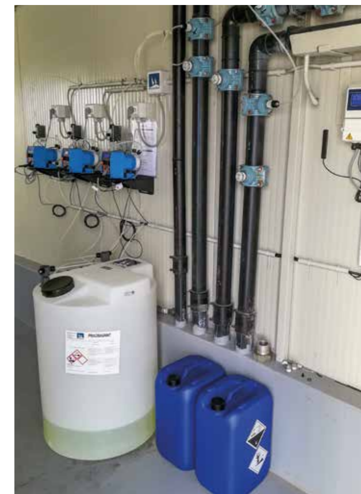
Оборудование для хлорирования продуктом Pragmasanit по трём разным линиям, с контролем предупреждений через модуль GSM.
